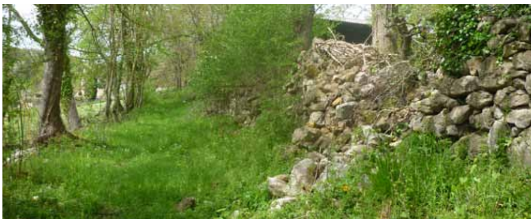
Effondrement d'une partie d'un muret de soutènement - Montesquieu Avantès
