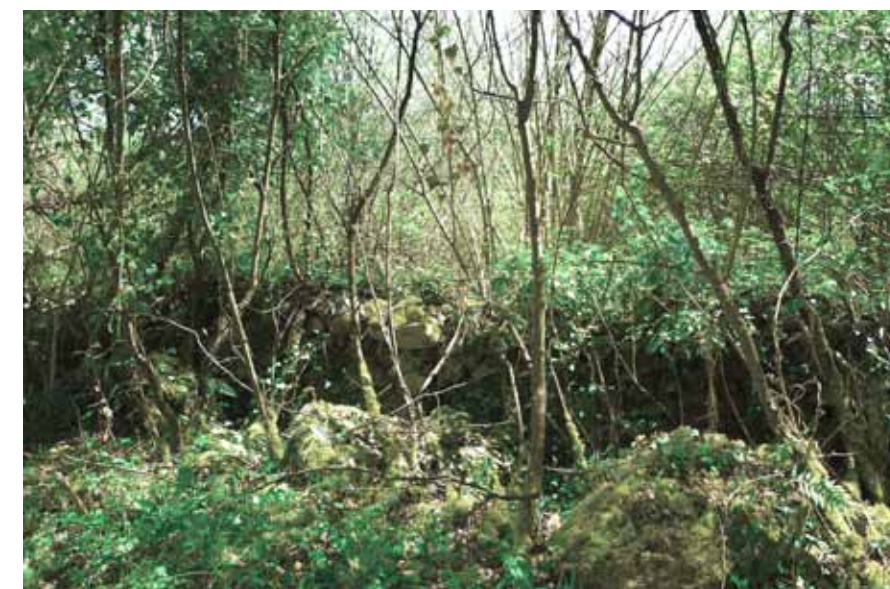
Muret envahi par les arbres et arbustes favorisant les risques d'effondrement - Pouncet
